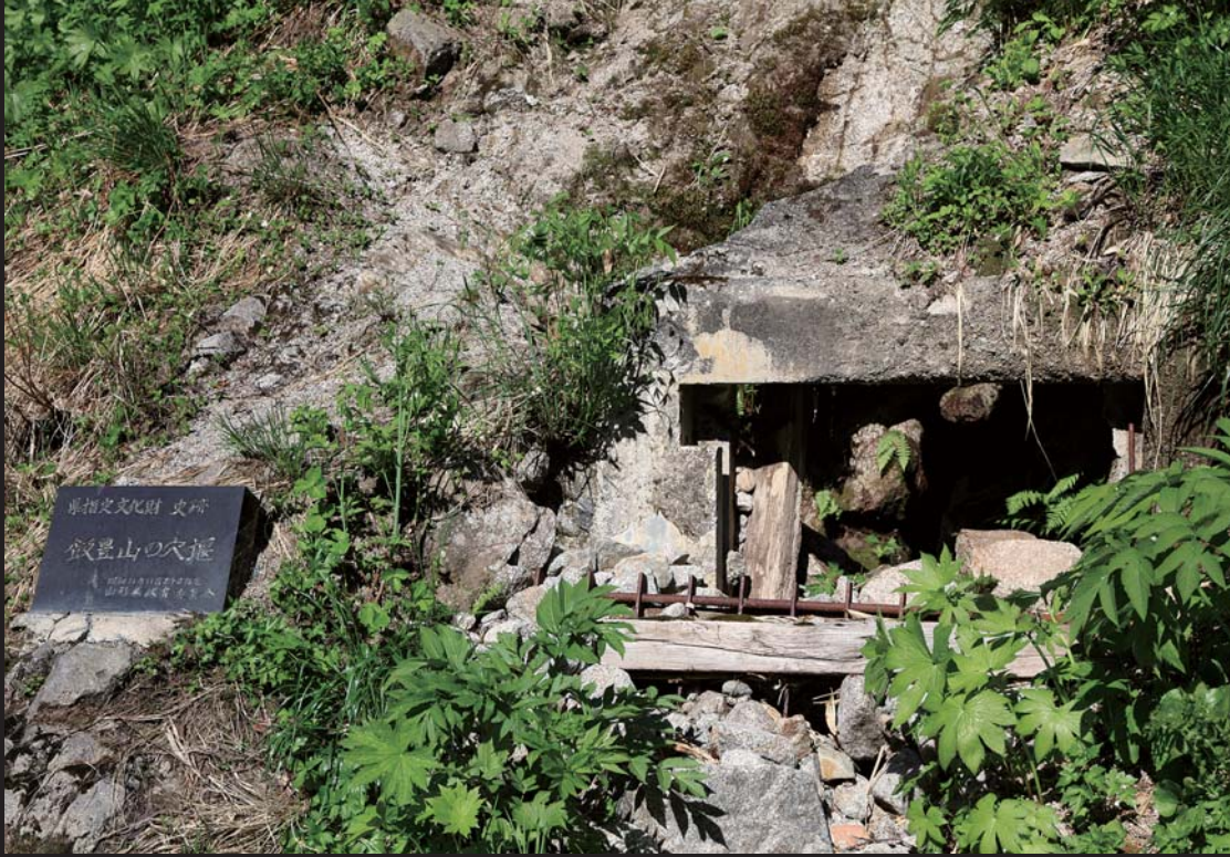
写真/平成23年7月、山口吉右衛門さん撮影の穴堰（御沢分かれ付近の取水口）。土砂が堆積し、天井が崩れている。
