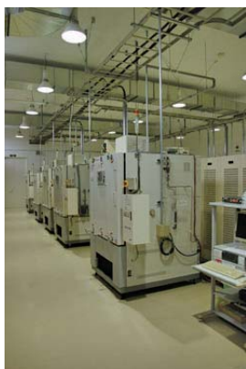
充放電試験室
