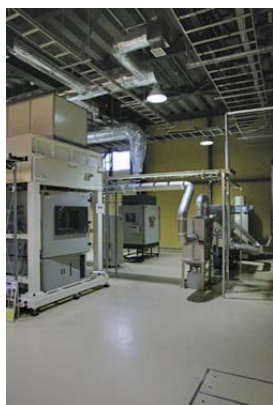
安全性試験装置室
