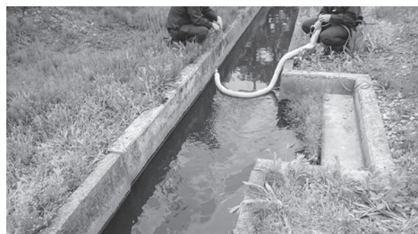
油漏れ事故対応の様子
