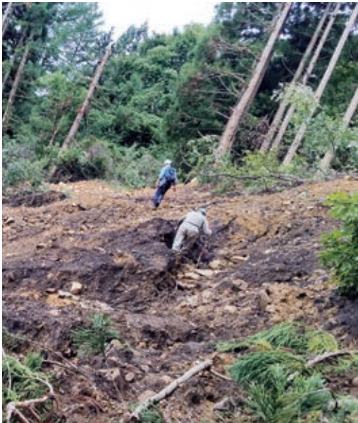
被災した町道新沼線
