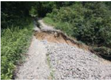
通行不能な林道
