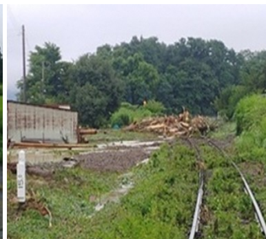
線路に堆積した流木
